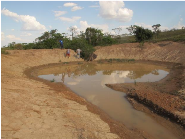
Foto 7: Barragem existente com a presença de ruptura. – 18/10/16
