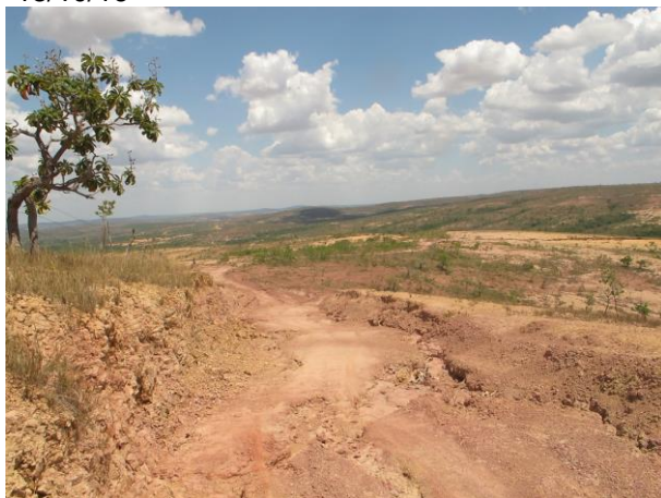
Foto 5: Presença de focos erosivos nas estradas vicinais. – 18/10/16
